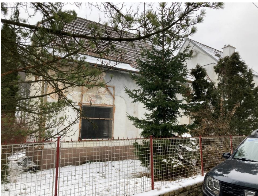
Abbildung 8: durch Brandereignis beschädigtes Objekt Millöckergasse 13, Quelle: eigene Aufnahme, 12.01.2024
